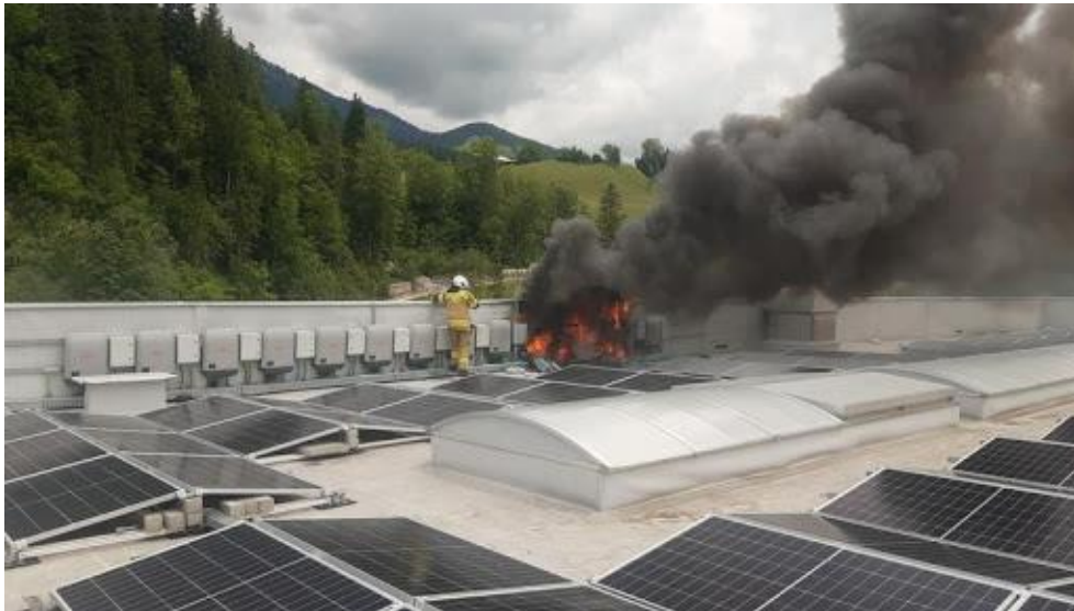
Bild 1: Brandentstehung auf dem Dach im Bereich WR und GAK (Quelle: Feuerwehr Abtenau)
