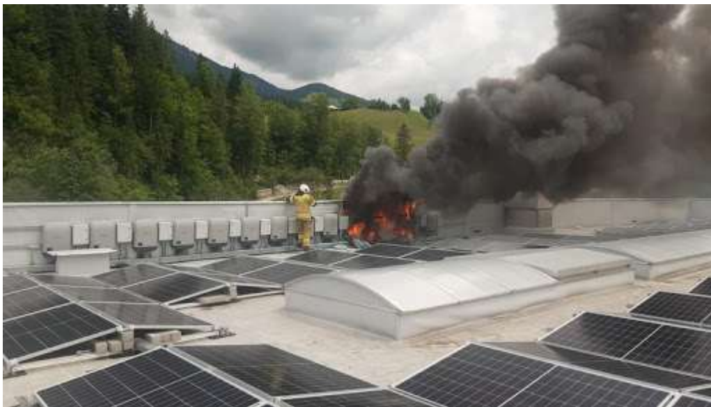
Bild 1: Brandentstehung auf dem Dach im Bereich WR und GAK (Quelle: Feuerwehr Abtenau)
